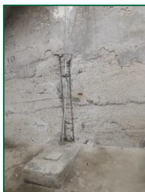
Presencia de humedad en una vivienda, dejando descubierto el acero.
