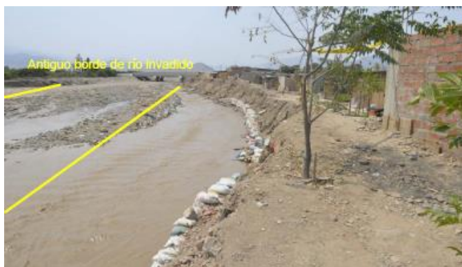
El río erosionó el material de relleno de la margen izquierda, sobre las cuales se asentaron varias viviendas que fueron destruidas. (CISMID, 2017)
