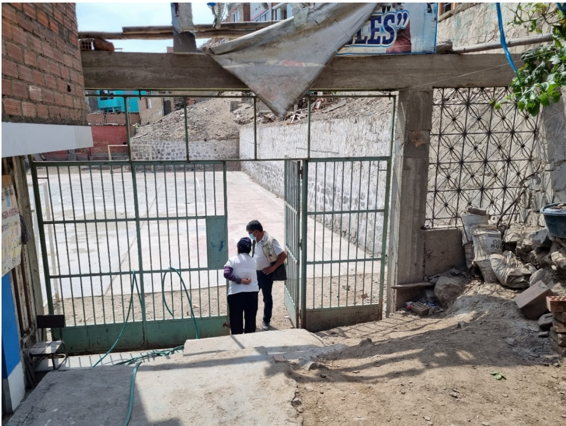
Ingreso a la losa deportiva, sobre silo en mal estado
