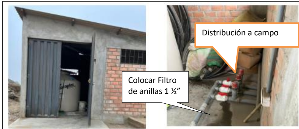
Figura 24 : Fotografía caseta de riego control y distribución
