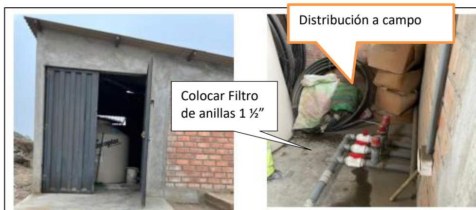
Figura 12. Fotografía caseta de control y distribución de riego
