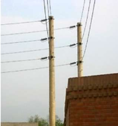
Foto N.º 6. LT CHAVARRÍA-PUENTE PIEDRA (L-636), DE 60 kV (RÍO CHILLÓN)
