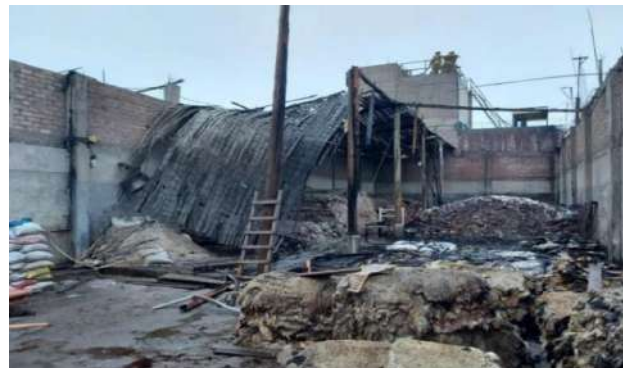
Foto N.º 19. 2/06/2021, 03:43 HORAS INCENDIO EN ALMACÉN DE FÁBRICA DE PLÁSTICOS, AV. PARADO DE BELLIDO, URB. CHACRA CERRO, COMAS
