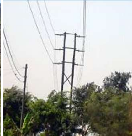
Foto N.º 8. LT NARANJAL-INFANTAS (L-635), DE 60 kV (RÍO CHILLÓN)
