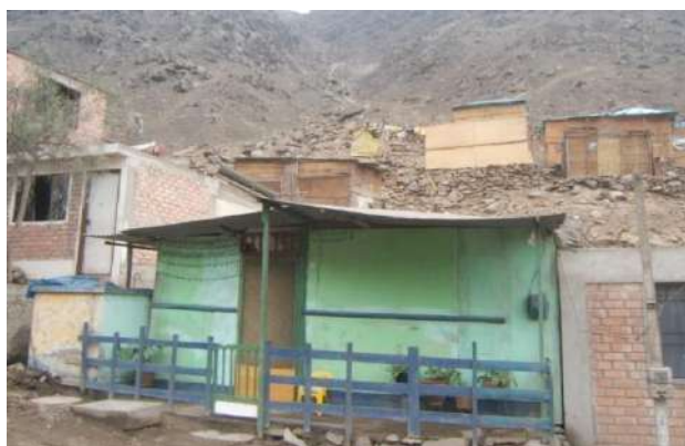
Foto N.º 37. ACUMULACIÓN DE BLOQUES SUELTOS, PRODUCTO DE ANTIGUAS CAÍDAS
