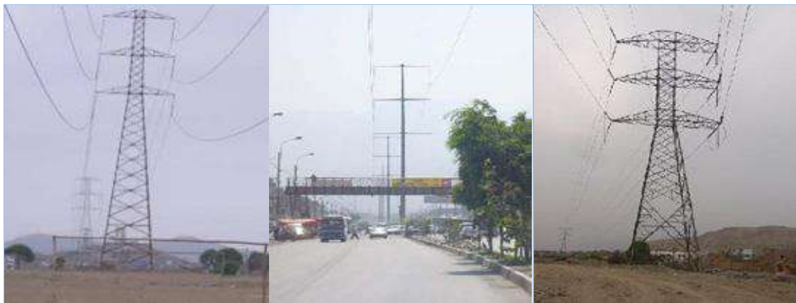
Foto N° 9: LT Ventanilla-Chavarría (L-2245), de 220kv.
