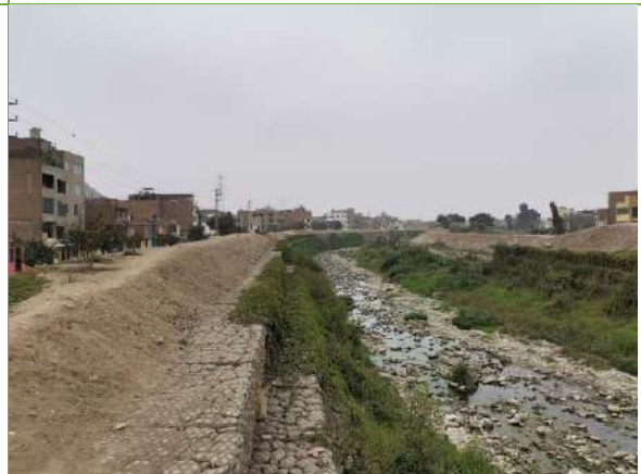
Vista de campo en la cual se aprecia gaviones en diferentes estados de conservación a lo largo del tramo del río Chillón
