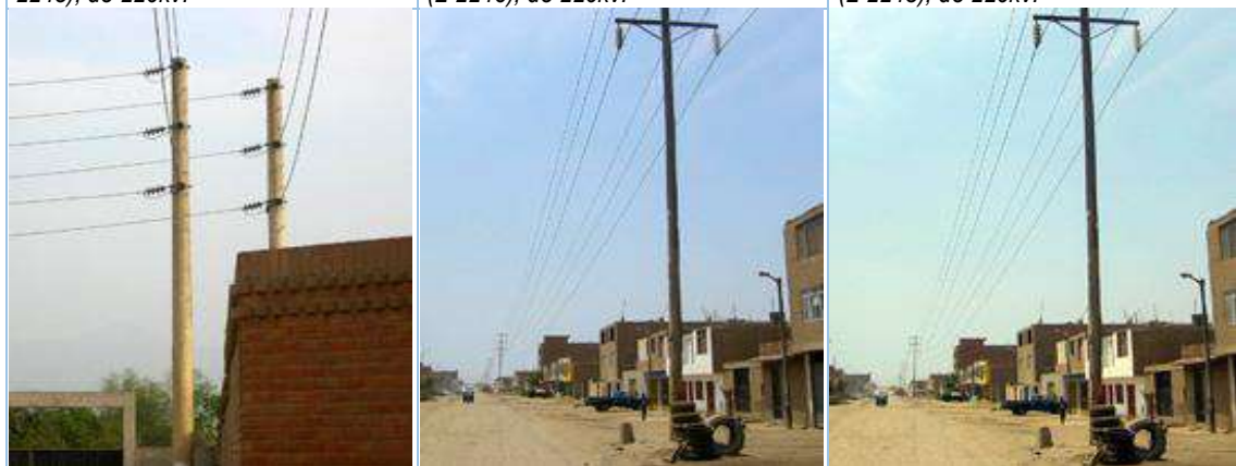
Foto N° 12: L.T. Chavarría-Puente Piedra (L-636), de 60kv,
