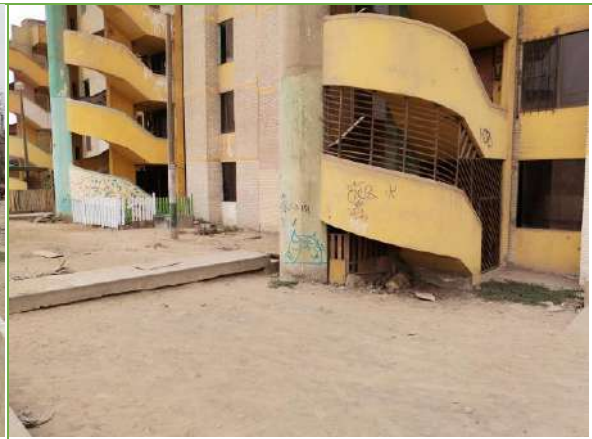
Inspección de una edificación en mal estado y abandonada ubicada en la vía Cantá Callao, a unos metros del cruce con la av. Cordialidad
