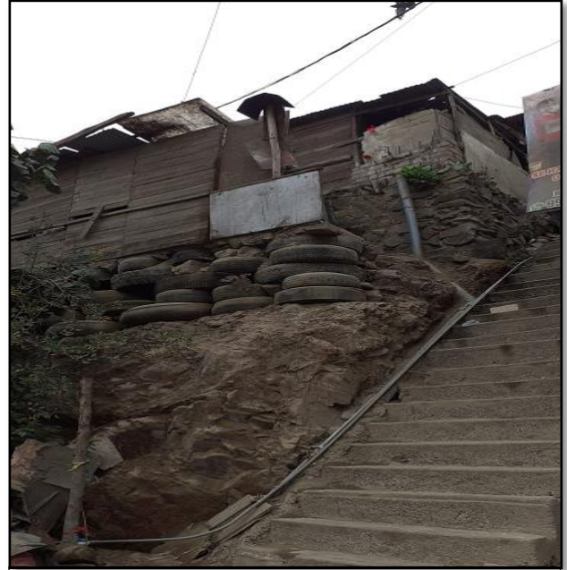
FOTO N°2: Se observa viviendas precarias construidas sobre terrazas realizadas mediante pircas y llantas, los cuales son inestables y podrían ceder ante un movimiento sísmico.
