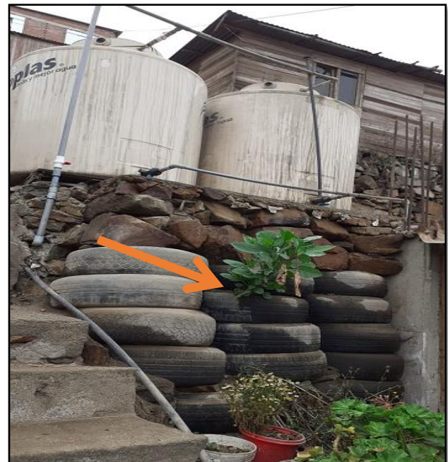
FOTO N°4: Se observa tanques de agua sobre piso pulido con bases de pircas y llantas poco compactadas sin ningún muro de contención, de producirse un sismo de gran magnitud podrían colapsar por inestabilidad de los taludes y perjudicar a la otra vivienda colindante.
