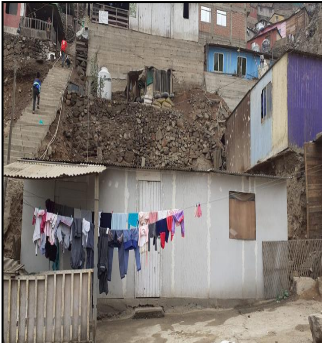
FOTO N°3: Se observa que la pendiente es fuertemente empinada y debido a la presencia de pircas inestables poco compactadas y debido a la ausencia de muro de contenciones podría producir caída de rocas.
