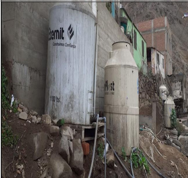
FOTO N°11: Se observa tanques de agua sobre bases precarias sin alguna base de cemento o sobre base sólida, de producirse un sismo de gran magnitud podrían colapsar por inestabilidad de los taludes y perjudicar a la otra vivienda colindante.
