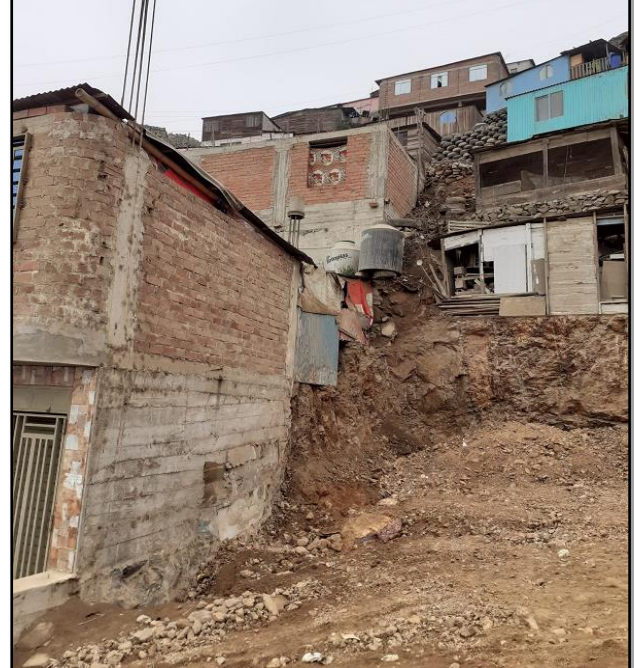
FOTO N°12: Se observa viviendas sobre taludes inestables con material de relleno sin un muro de contención en zonas susceptibles a Caída de rocas.
