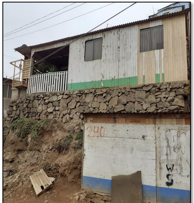
FOTO N°8: Se observa vivienda sobre taludes inestables con material de relleno y sin muro de contención en zonas bajas de las laderas.
