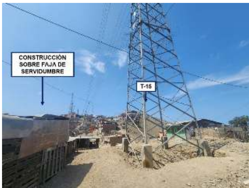
Fotografía 2 – Vivienda dentro de la faja de servidumbre de la torre T-15
