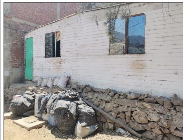
En esta vista el predio requiere la estabilización de las pircas y evaluación de muros de contención.
