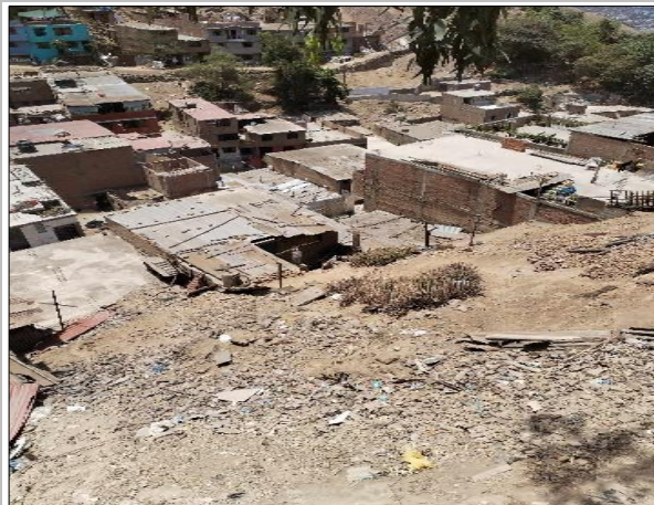
En esta vista se requiere el enmallado para la prevención de caída de rocas y deslizamiento de tierras, sobre las edificaciones, ya que estas viviendas presentan techo de calamina.
