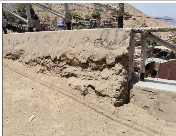
En esta vista se requiere el mantenimiento del muro de contención y renovación de las barandas.
