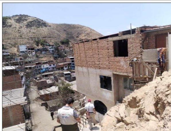
En esta vista el predio requiere de la limpieza de escombros y estabilización del talud.
