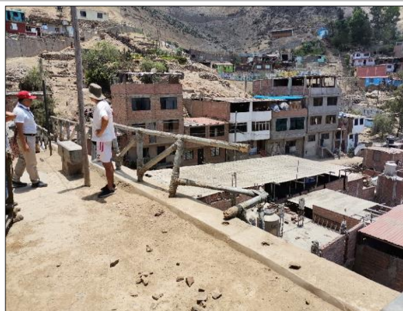
En esta vista se requiere el mantenimiento del muro de contención y renovación de las barandas.
