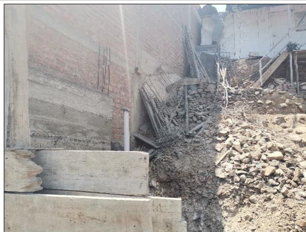
En esta vista se requiere de la estabilización de taludes y limpieza de escombros, reforestación en la parte alta y el reforzamiento de una zona segura.
