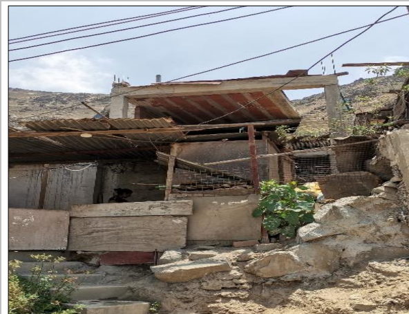
En esta vista el predio requiere la estabilización de taludes, muros de contención y reforzamiento de una zona segura.
